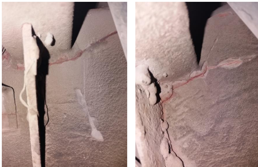
Рисунок 3 – Тріщини правого лонжерона перерізом 140x60x3 мм
